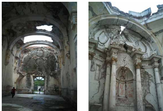
Fotografía 2. Daños del templo de San Juan Raboso.
