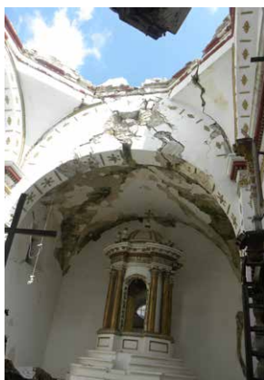
Fotografía 4. Colapso de la cúpula del templo de San Agustín en Tepexco.
