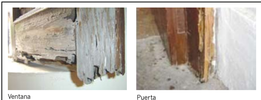
Figura 41. Devastación por termitas.
